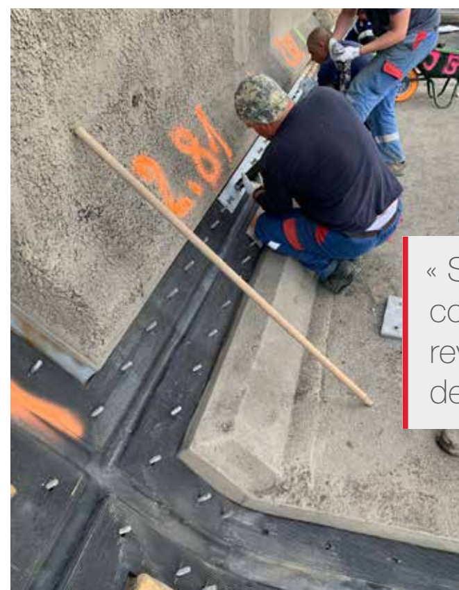
Des ouvriers du groupe Jean Boutique procèdent au serrage des écrous sur les plaques métalliques couvrant les bords des joints.
